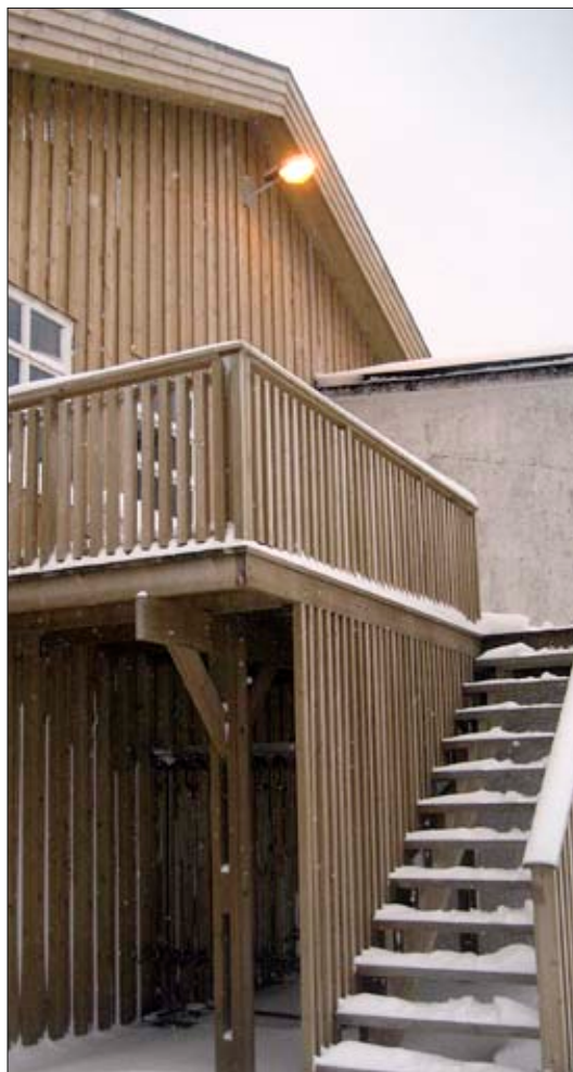
Uheldig bruk av materialer og uheldig utforming i forbindelse med utbedring. Foto: Kulturminnefondet.
