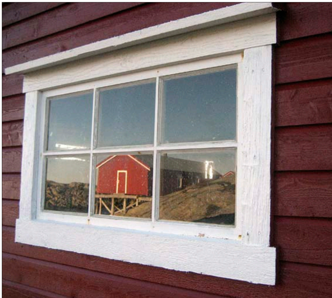
Detalj som viser bruk av stifter som innfesting. I kystklima vil man oppleve at stiftene ruster. Foto Kulturminnefondet.
