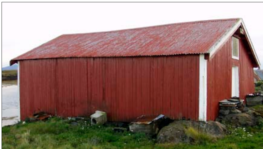
Før utbedring. Foto: Kulturminnefondet.
