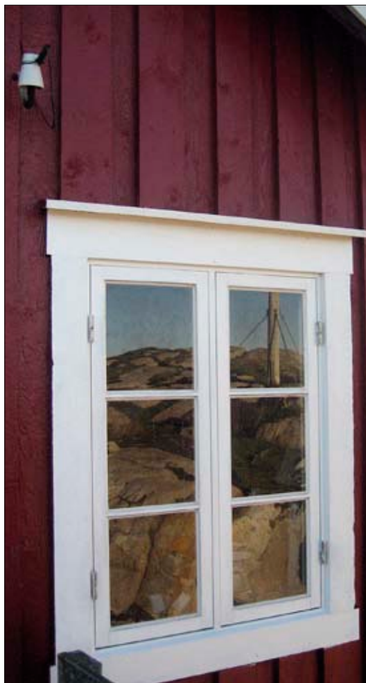
Eksempel på kopi av vindu hvor karm og ramme er overdimensjonert i forhold til opprinnelig. Foto Kulturminnefondet.
