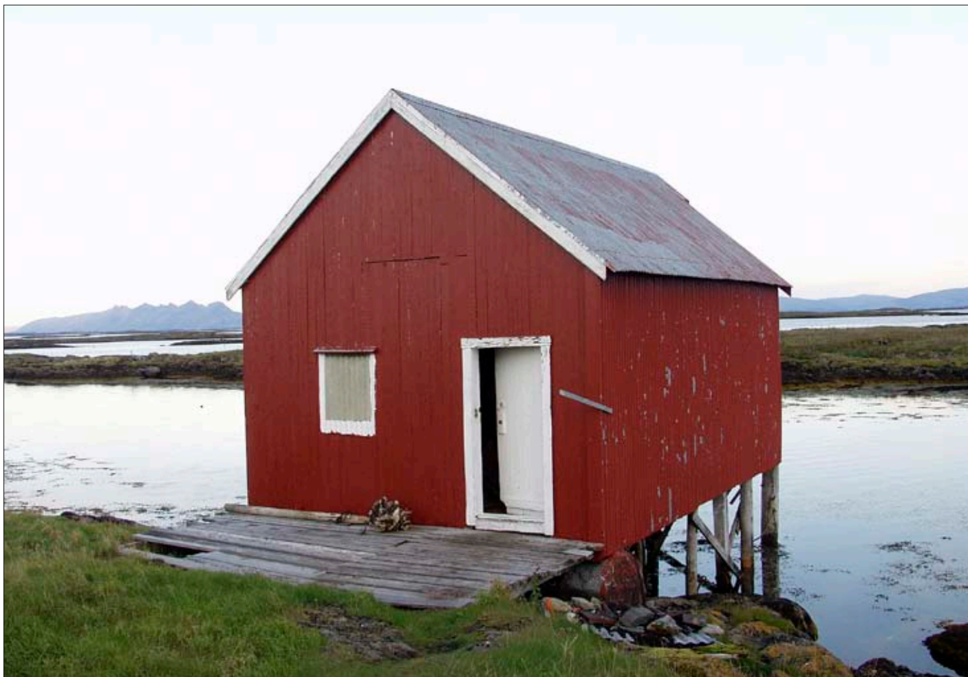
Før utbedring. Foto: Kulturminnefondet.
