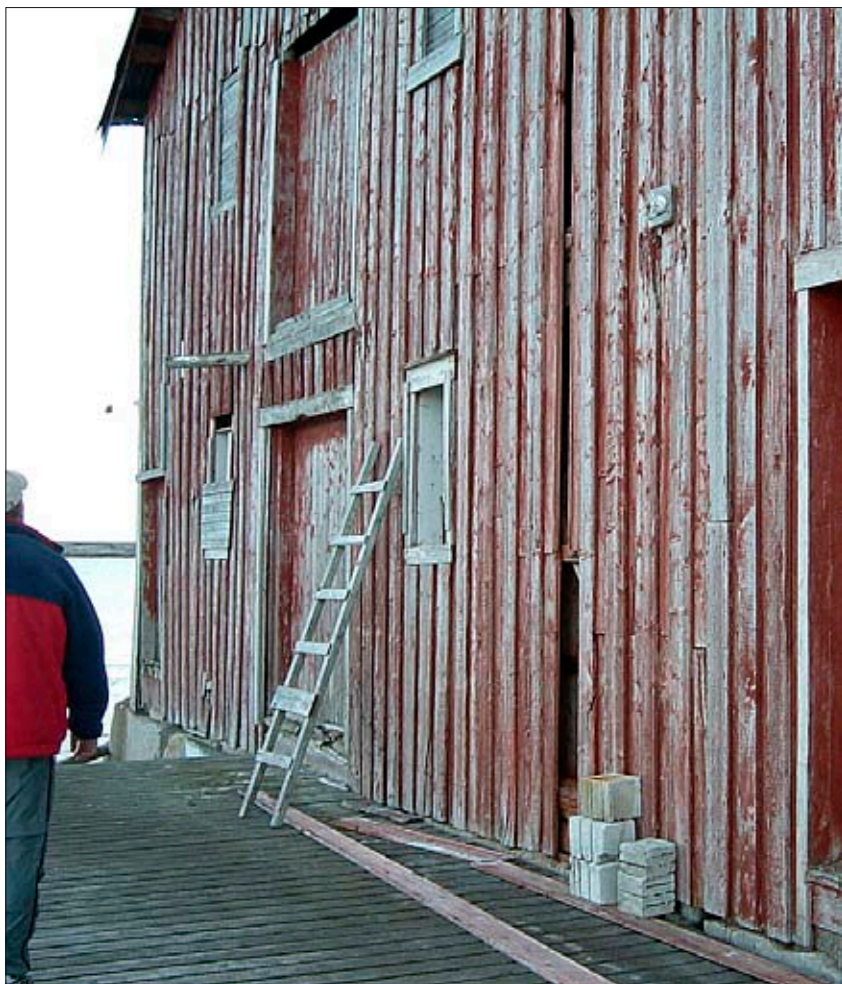
Brygge før istandsetting. Bildet viser behov for istandsetting. Foto fra rapport
