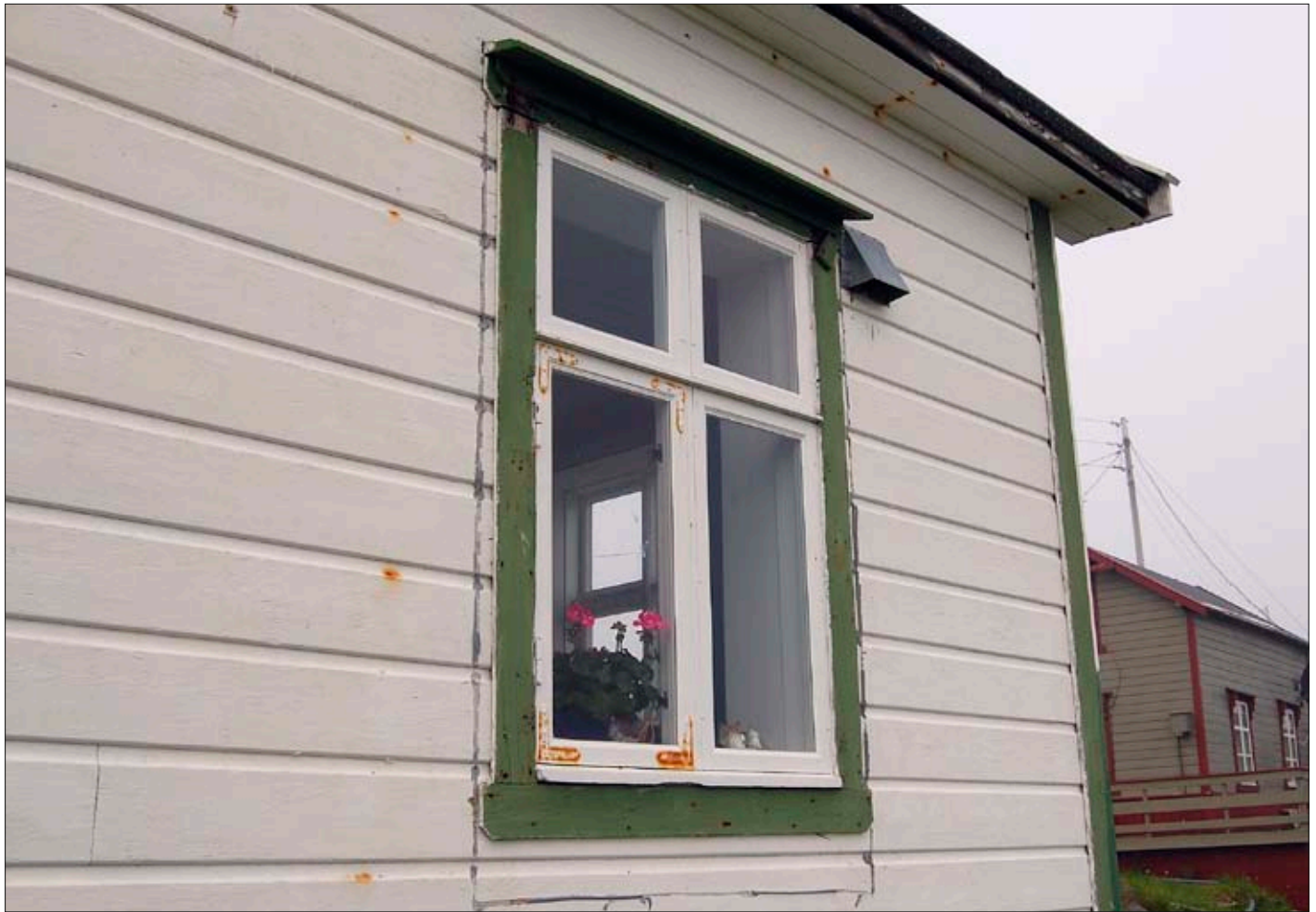
I kystnære strøk er rustskader på spiker og beslag vanlige. Foto Kulturminnefondet.
