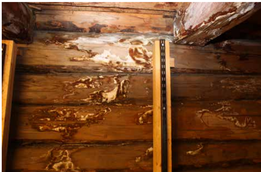
Skader i østre hjørne av 2.etg som følge av for mye fukt. A
