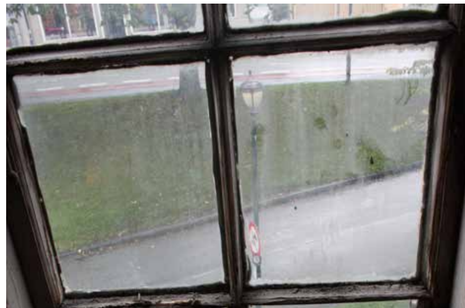
Vinduene er fra 1800-tallet og har fått fuktskader over tid. A
